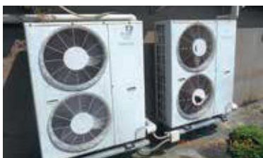
Původní klimatizační split systém
