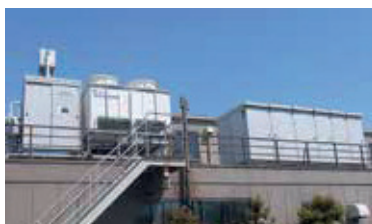
Plinski absorpcijski Chiller
